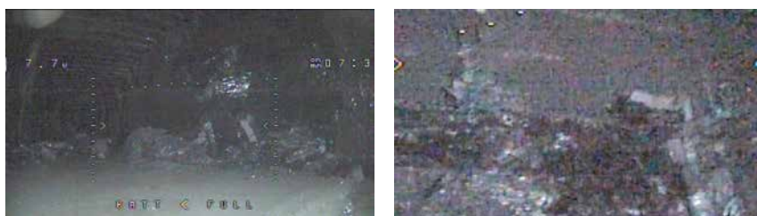
Рис. 3. Разрушение межкамерного целика
